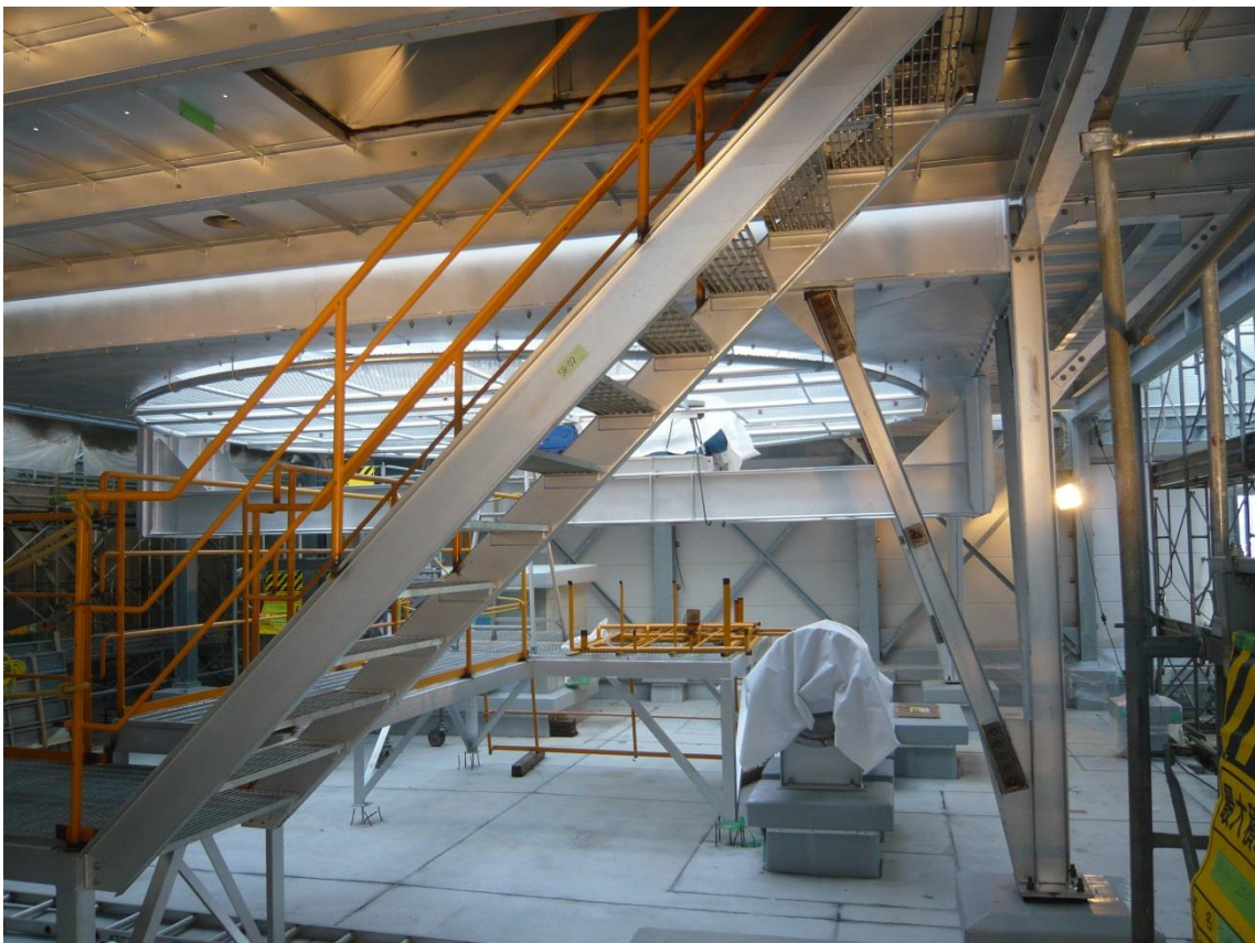
屋上階に設置されるタービン排気復水器のメンテナンスステージの状況です。
