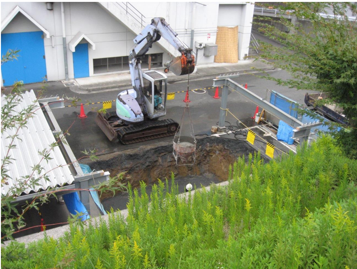
既存棟から蒸気タービン棟へ熱源を送る配管ブリッジの基礎工事が始まりました。
