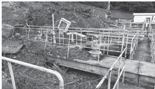
別所浄水場内へ土砂流入
