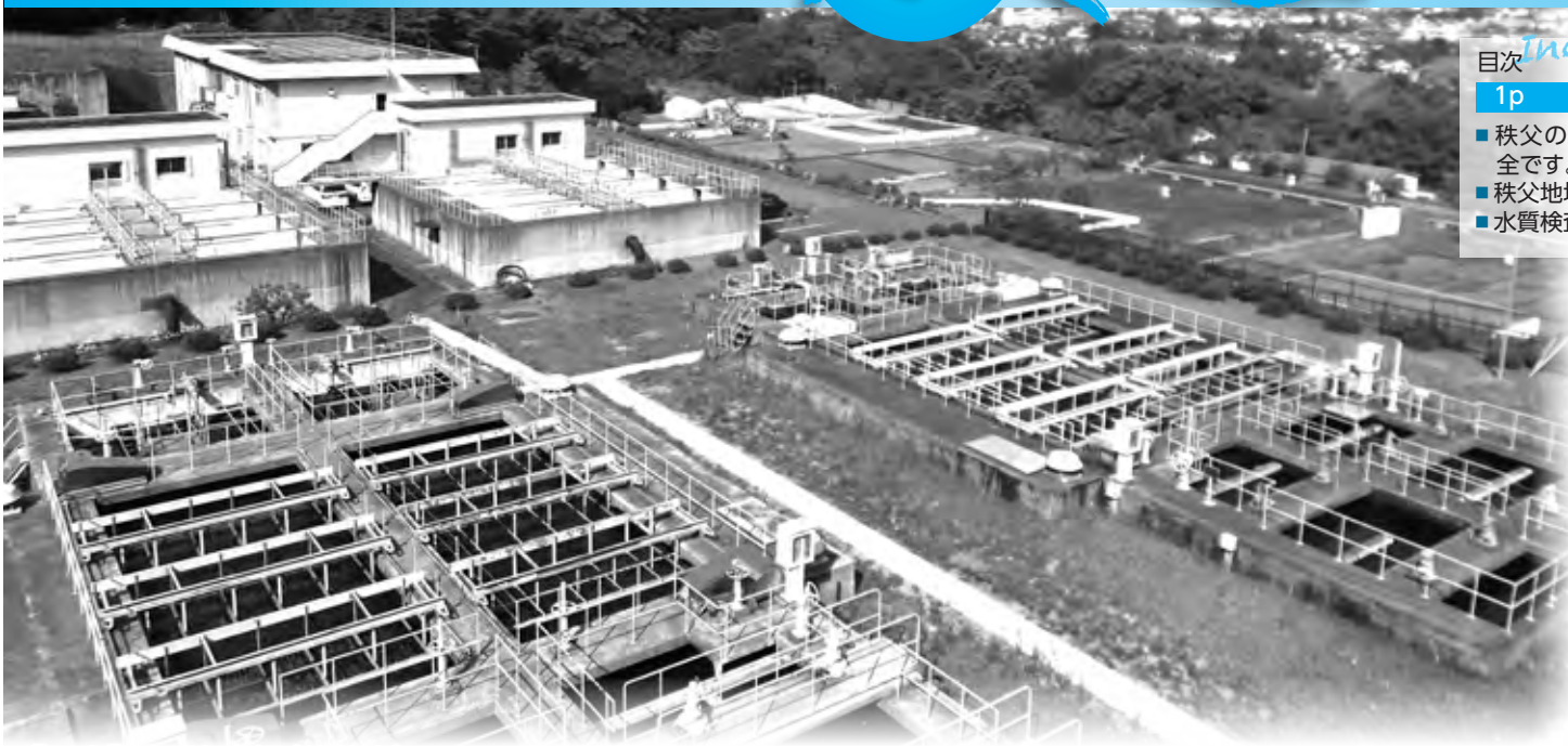
【写真】別所浄水場(秩父市) ※別所浄水場で取水している原水のほとんどが、大滝地域から導水路により直接運ばれているものです。
