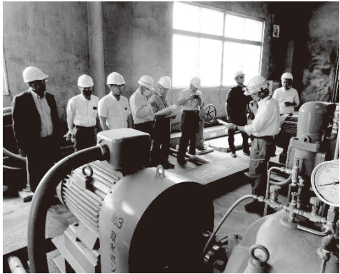
別所取水場 ポンプ室
